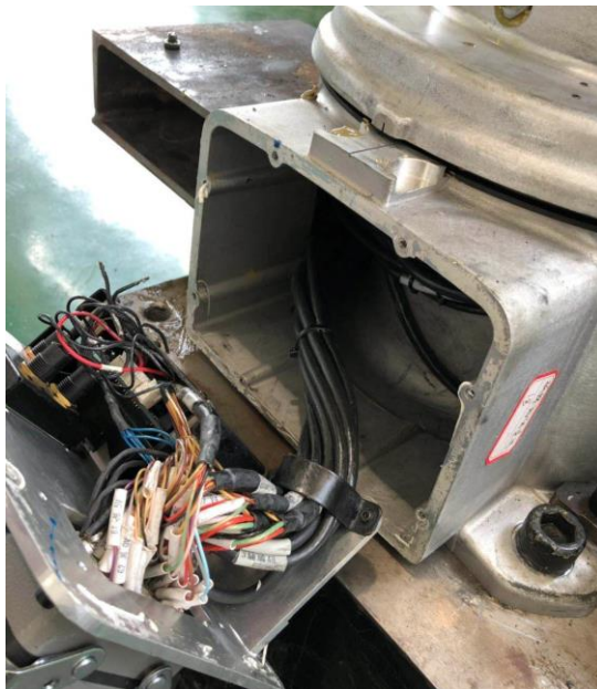
图 11-2 底座内部线缆
